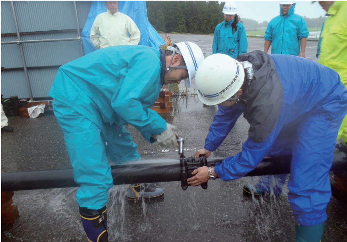
技術継承訓練 (松田新田配水場)
