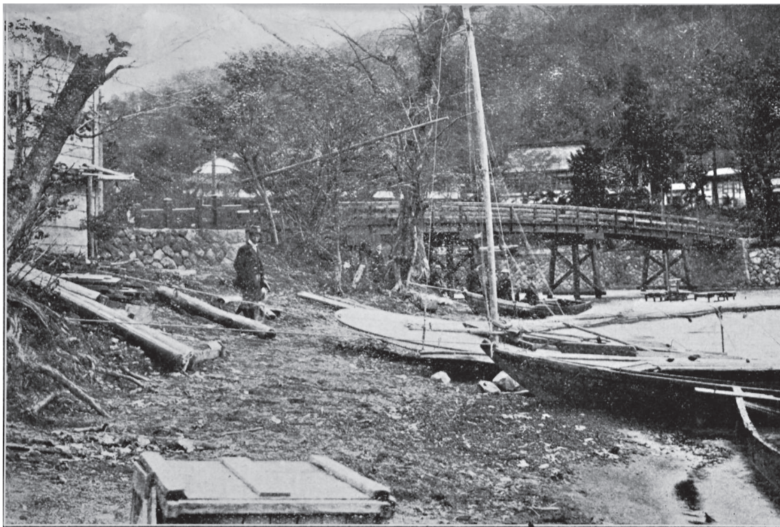
図1-14 中禅寺湖の補水口工事の様子(『宇都宮市水道畧誌』〈福田輝家文書：栃木県立文書館寄託〉)
