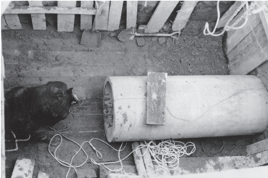
図5-4 国鉄(現在のJR)日光線軌道下付近での布設工事(昭和40年12月)
