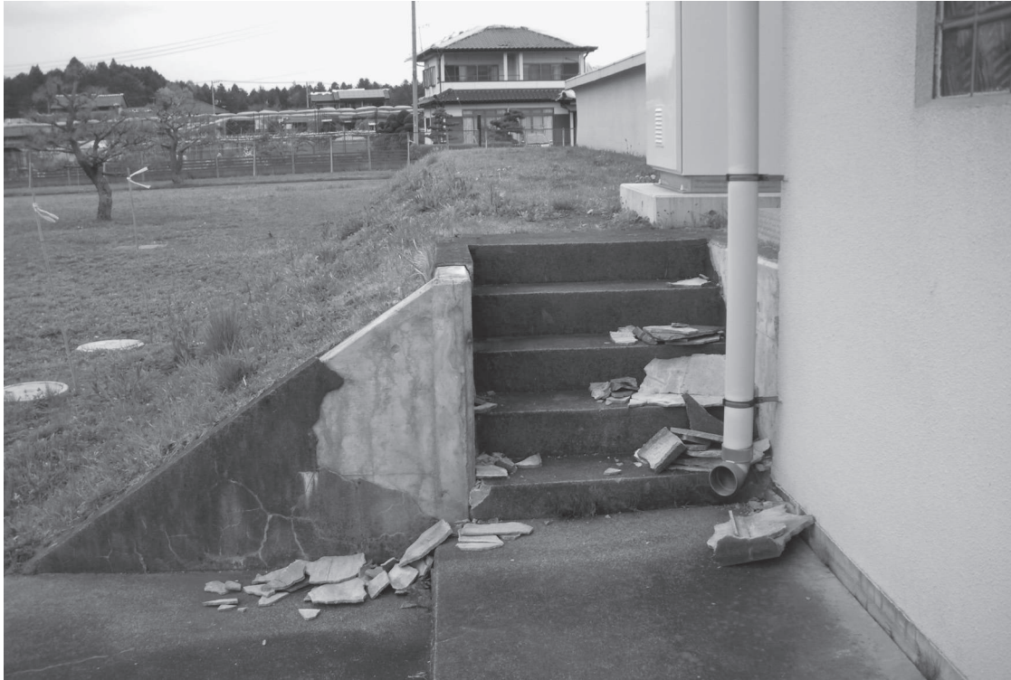
図7-18 震災の被害状況(白沢配水場)
