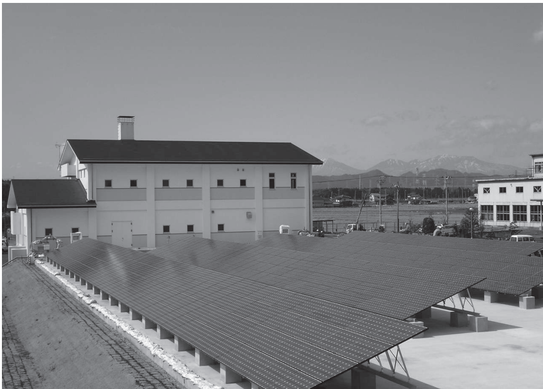
図7-11 白沢浄水場の太陽光発電設備
