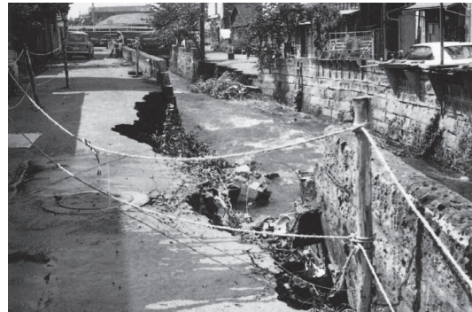
図S5-4 氾濫でえぐりとられた釜川の沿道(昭和46年：『釜川のあゆみ 釜川竣工記念誌』)
