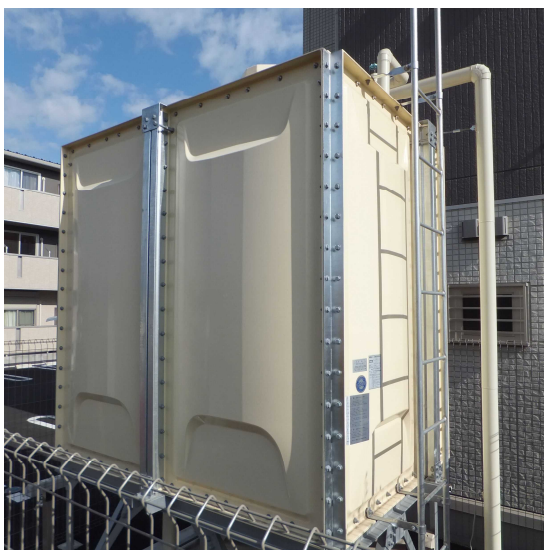
小規模貯水槽水道
