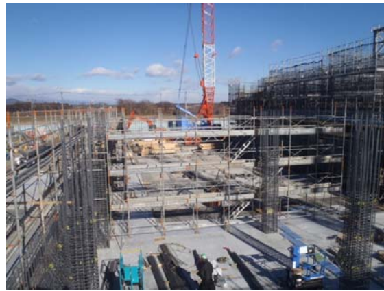
プラットフォームエリア(ごみ焼却棟)
