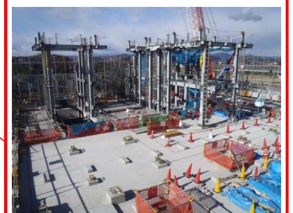
炉室・発電エリア(ごみ焼却棟)
