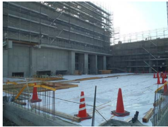
プラットホームエリア(ごみ焼却棟)
