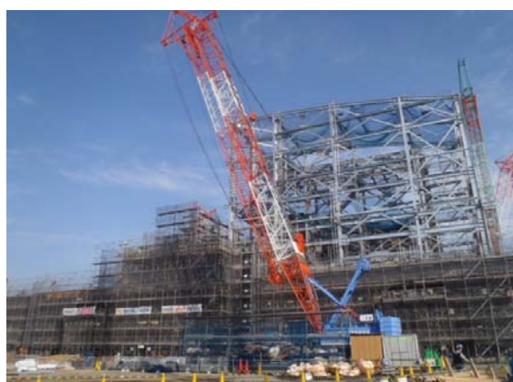
発電エリア(ごみ焼却棟)
