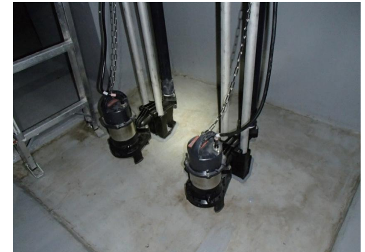
樹脂製水中ポンプ
