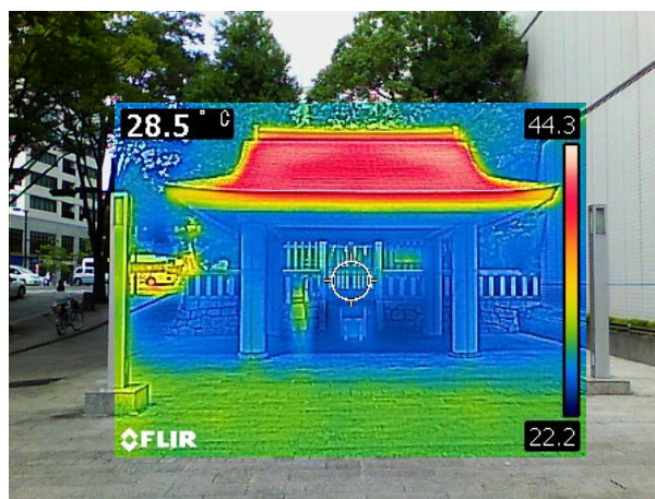
図 3.3.4 地点 L のサーモグラフィ
