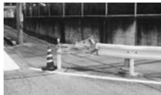
▲壊れたガードレール
