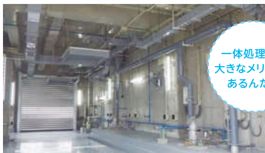
浄化槽汚泥等受入施設(内観)
