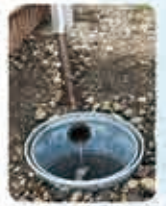
雨水浸透ます
