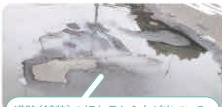
道路(舗装)の切れ目から水が出ている
