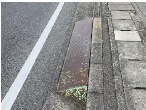
自転車の走行支障物件例
