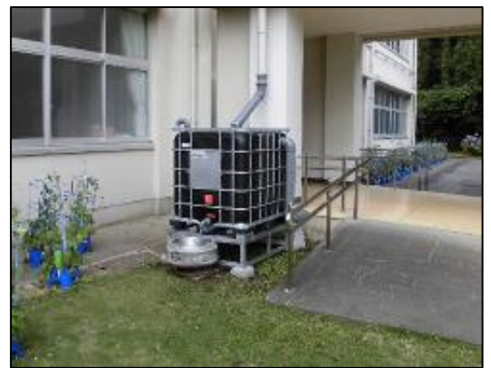
雨水貯留タンク（小学校）
