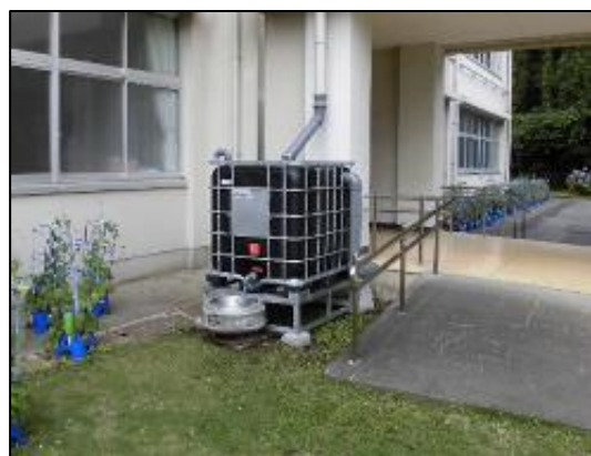
雨水貯留タンク（小学校）
