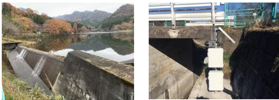
図 3.16 赤川ダム余水吐・堤体状況を監視するために設置したカメラ
