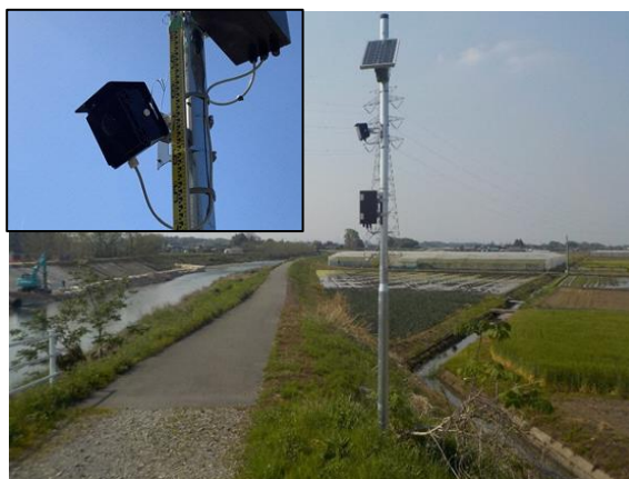
図 3.17 栃木県が導入している河川監視カメラ
