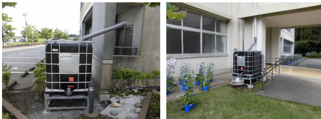
図 3.8 公共施設での貯留タンク設置
