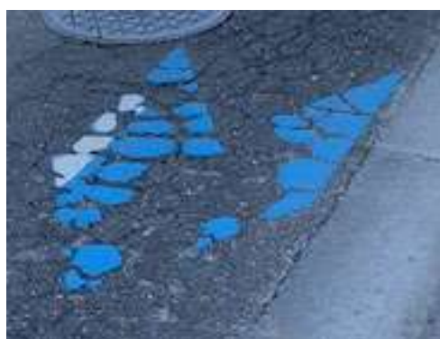
老朽化により視認性が悪化した矢羽根
