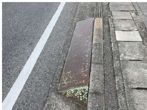
自転車の走行支障物件例
