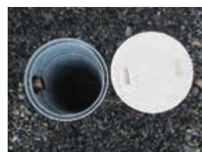
2 雨水浸透ます
