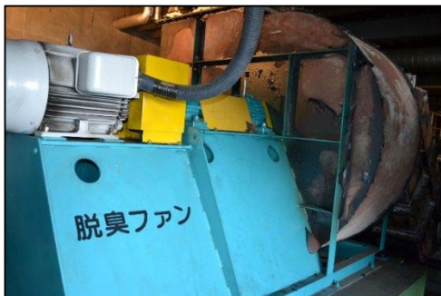
写真② 脱臭装置
