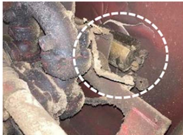
写真2 放水銃 [No.1] : 内部
