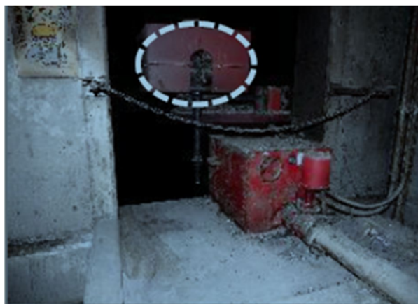
写真1 放水銃 [No.1] : 外観
