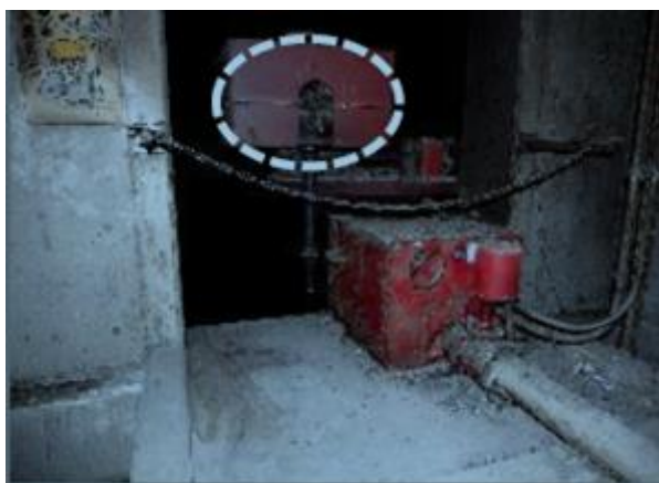
写真 2 - 1. 放水銃 [No. 1] : 外観
