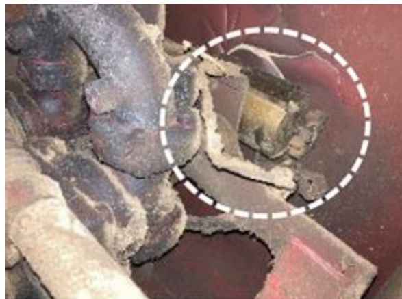
写真 2 - 2. 放水銃 [No. 1] : 内部
