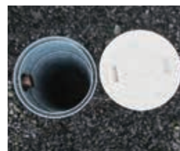
2 雨水浸透ます
