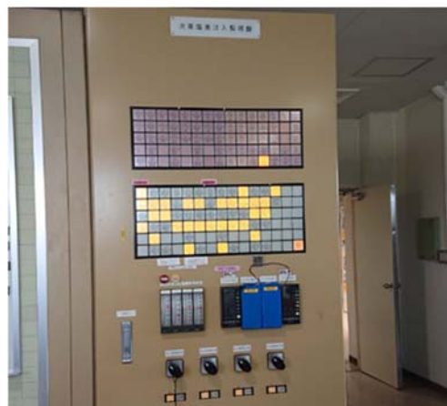
塩素注入監視盤
