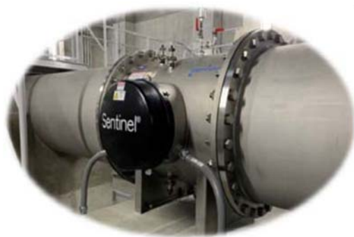
紫外線処理設備
