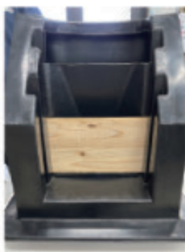
排水調整マス
