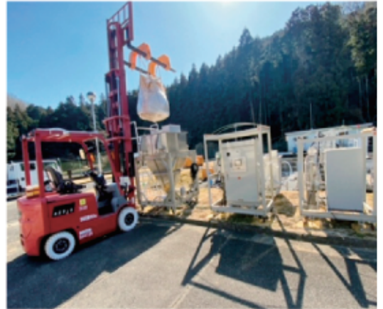
活性炭注入設備
