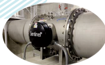
紫外線処理設備
