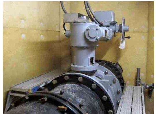
上戸祭制御所(上戸祭制御弁室の制御弁)
