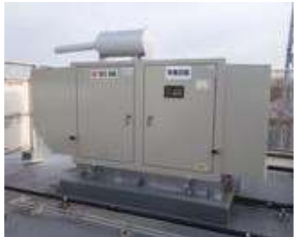
非常用発電機
