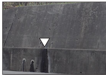
地下水の流出
