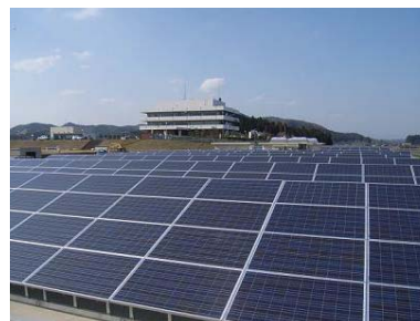
▲ 太陽光発電（松田新田浄水場）
