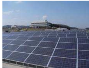
▲太陽光発電（松田新田浄水場）
