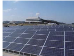
▲太陽光発電（松田新田浄水場）
