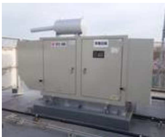
図4.32 非常用発電機
