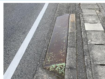
自転車の走行支障物件例
