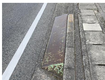
自転車の走行支障物件例
