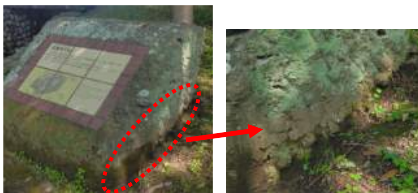
図 57 サイン施設台の劣化の様子
