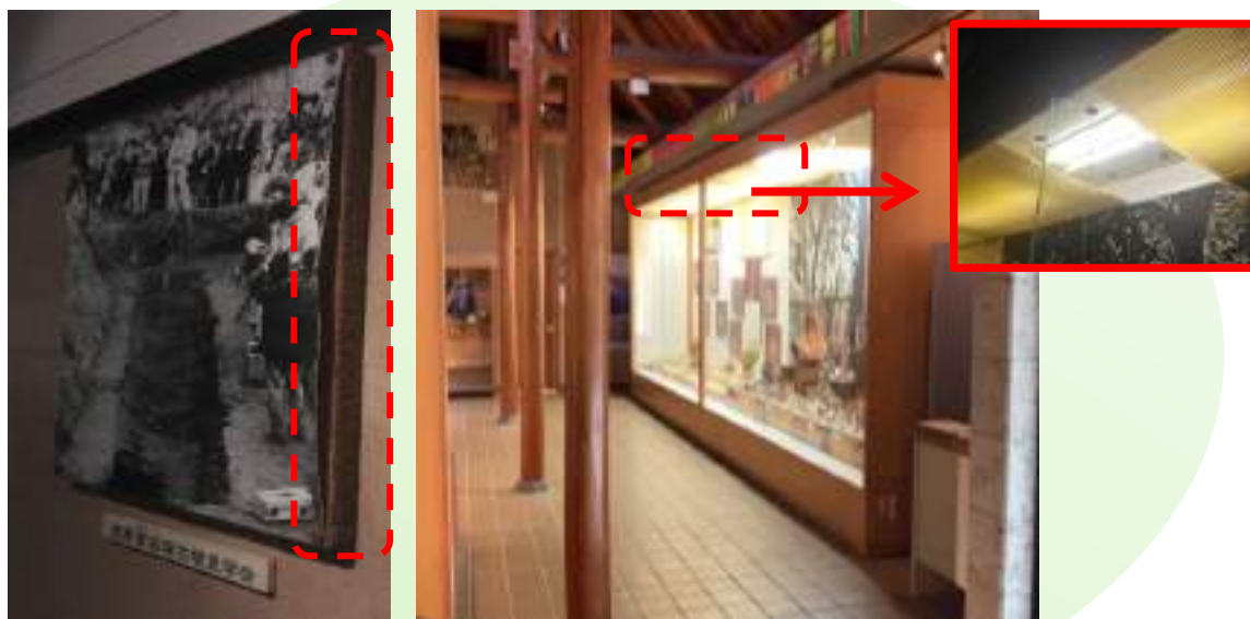
図 59 解説パネルの剥離等
