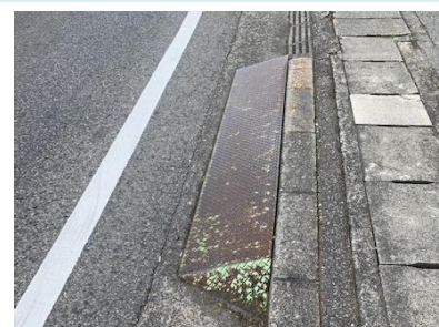
自転車の走行支障物件例
