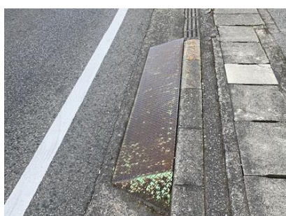
自転車の走行支障物件例
